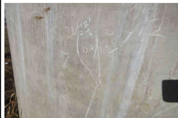
교각 균열(0.3mm미만) P2
