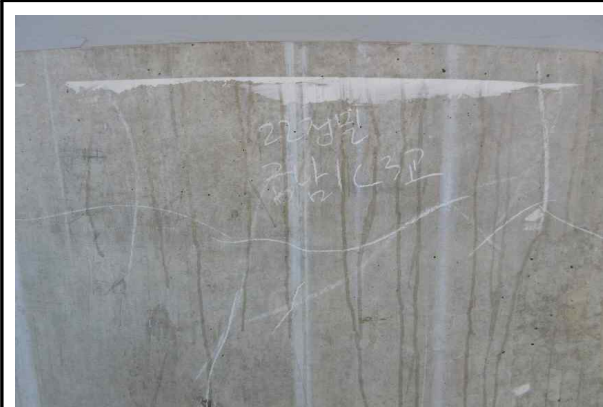
교각 망상균열 P1
