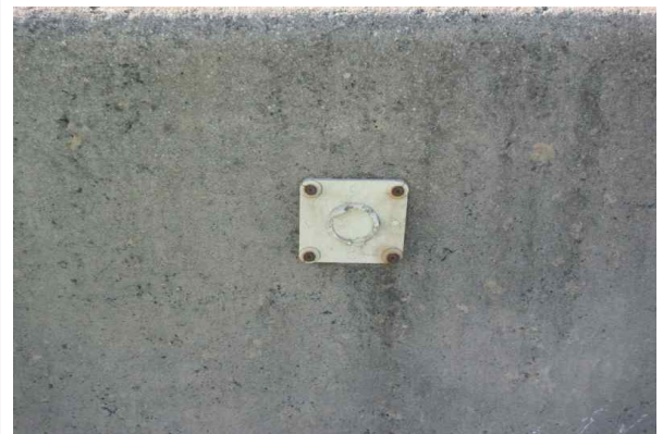
텔레네이트 파손 S3
