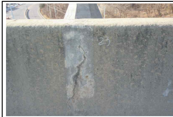
방호벽 보수부 재균열(0.3mm 미만) S2
